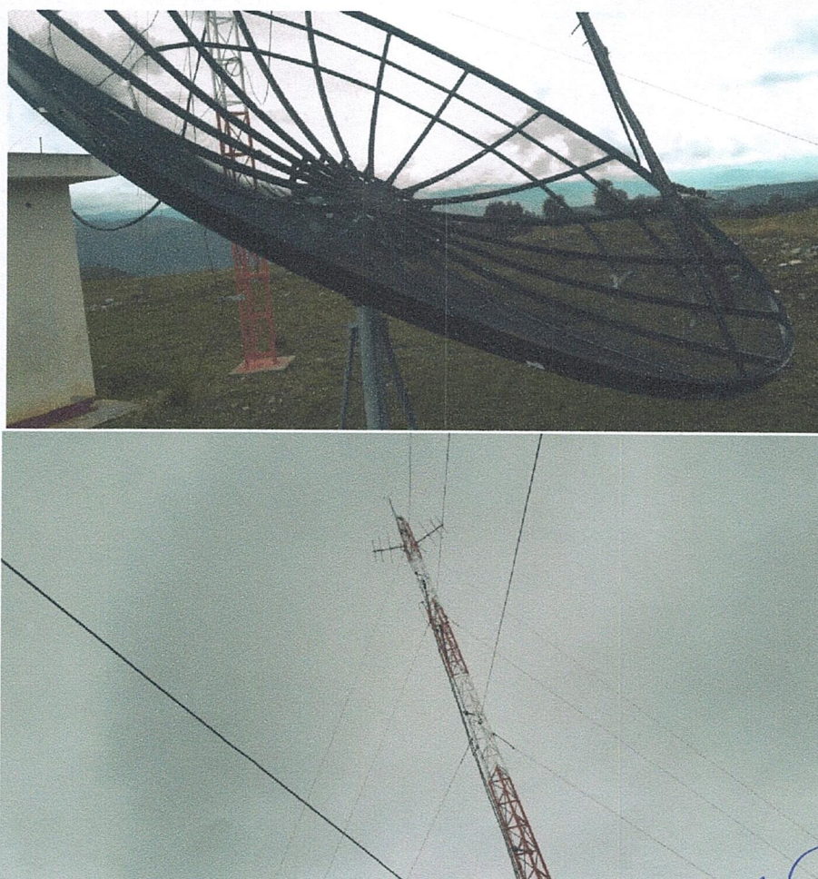
Ilustración 4,5. Sistema radiante necesita mantenimiento preventivo
