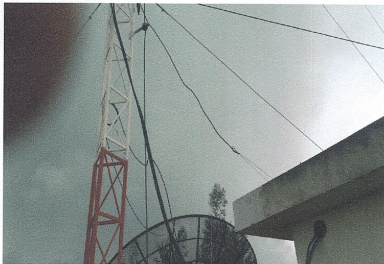
Ilustración 2. Se puede verificar mala instalación con la cablería sin peinar que hay en el sistema radiante y además la mala instalación que hay en el sistema eléctrico desde la acometida con empalmes sin protección y sin línea a tierra en la caseta de comunicaciones y a los tomacorrientes.
