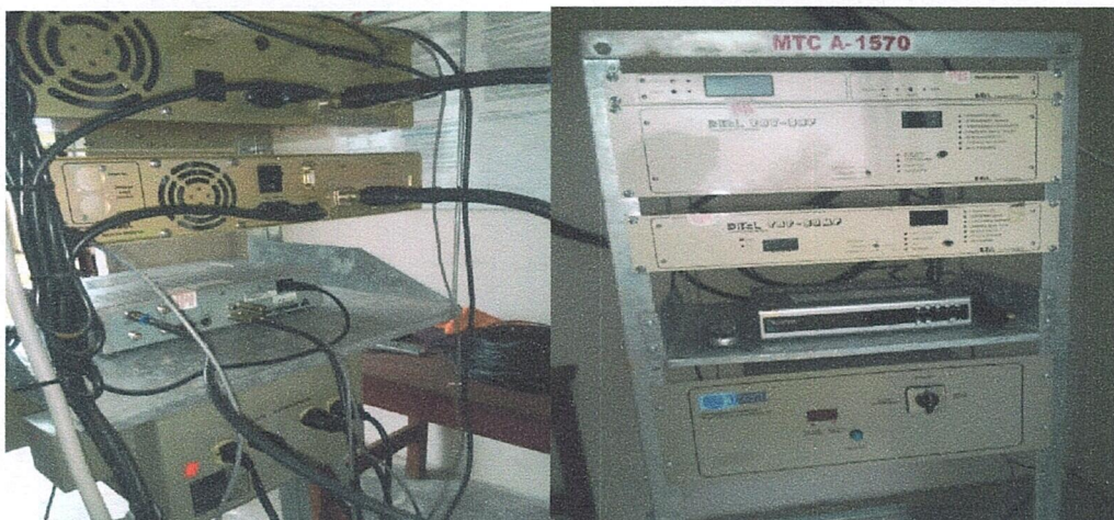
Ilustración 3. El rack de comunicaciones se debe dar para Para un mejor aterramiento a los equipos se tendrá que ofertar una tabla de aterramiento independiente para el rack de comunicaciones TBG
