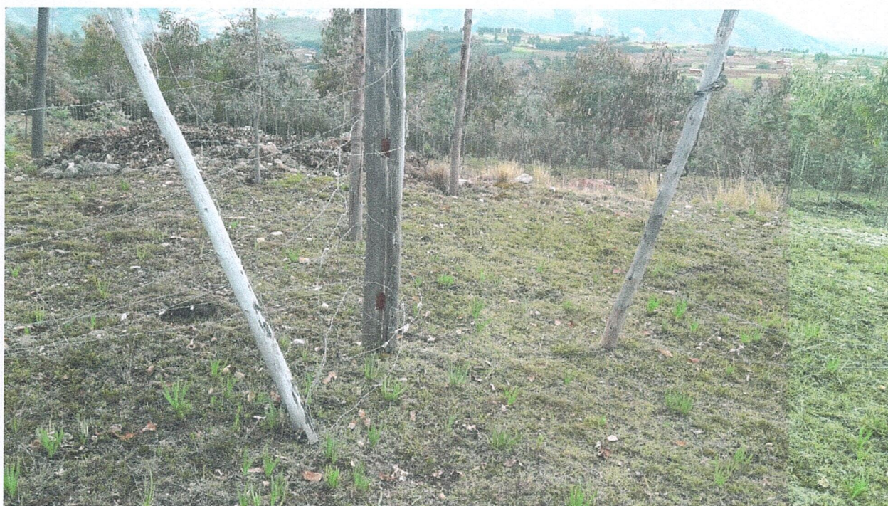
Ilustración 11. Fotografía del Cerco perimétrico derrumbado.
