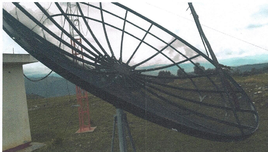
Ilustración 6. Se tiene que hacer Mantenimiento de antena parabólica, cambio de pétalos y pintura de soportes. También se puede verificar que no hay cerco perimétrico para protección de equipos.
