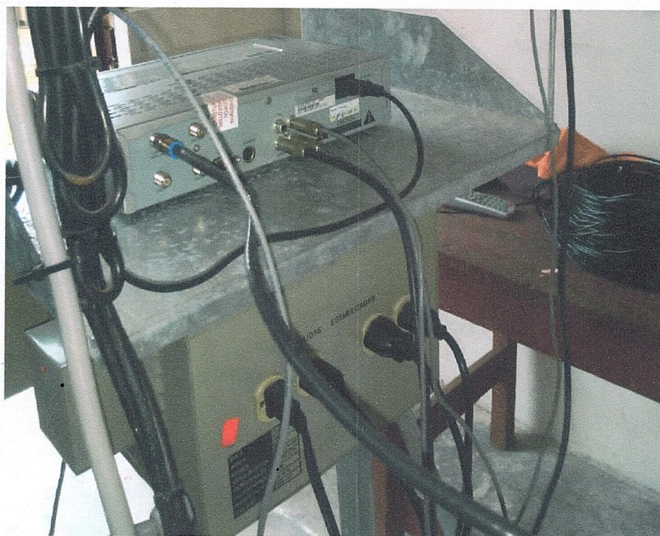
Ilustración 7. Equipos de comunicaciones se están funcionando pero se necesita hacer un mantenimiento preventivo y correctivo.
